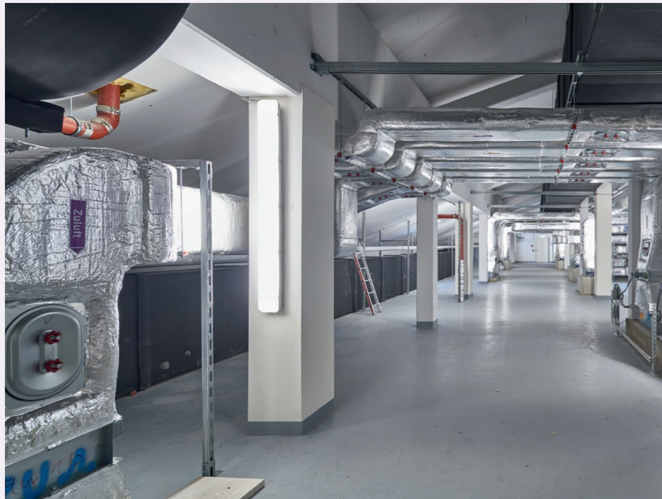
EINE NEUE LÜFTUNGSZENTRALE VERSORGT DIE KLASSENZIMMER MIT FRISCHER LUFT - SO KÖNNEN DIE SCHÜLER KONZENTRIERT ARBEITEN
